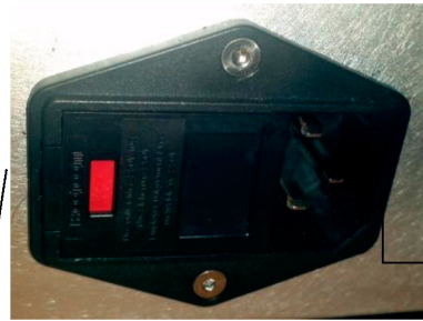
lokacija osigurača sustava
